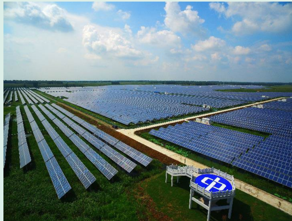
中國江蘇省泗洪太陽能光伏電站
