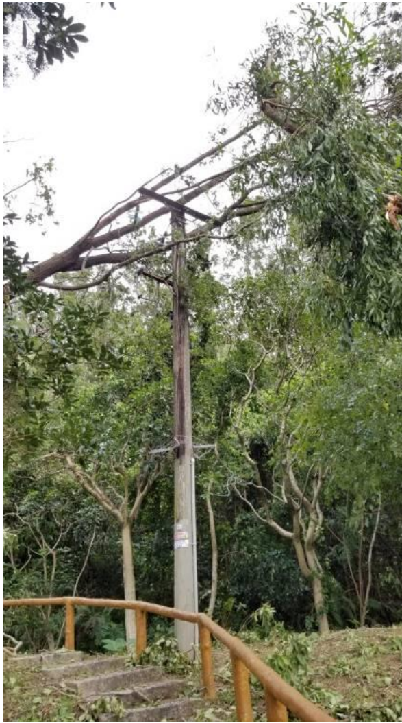
颱風後，中華電力的供電設施損毀嚴重。
