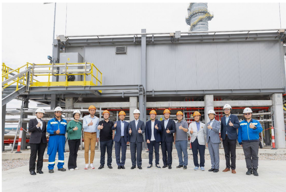
立法會議員參觀設於架高地台上的 D2 新燃氣發電機組掣房，作為應對極端天氣措施的示例。
