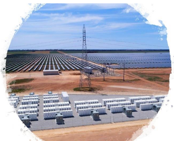
▲ EnergyAustralia 的大型儲能電池庫提供可靠的能源，有助於維護能源憲章的其中一項原則。
